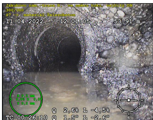
Obrázok 1. Zatopenie kanalizačného potrubia
