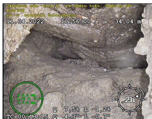
Obrázok 2. Prevalenie kanalizačného potrubia
