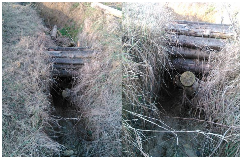
Obr. 6 Fotodokumentácia stavu jednej z drevených prehrádzok vybudovaných v rámci programu „Revitalizácia krajiny a integrovaného manažmentu povodí SR“
